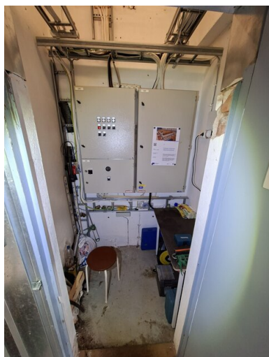
Sähköpääkeskus: Yleiskuva tilan ovelta päin kuvattuna.
